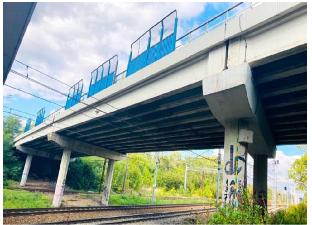
Wiadukty w ciągu ul. Mikołowskiej będą sukcesywnie rozbierane, a w ich miejsce pojawią się nowe konstrukcje.
