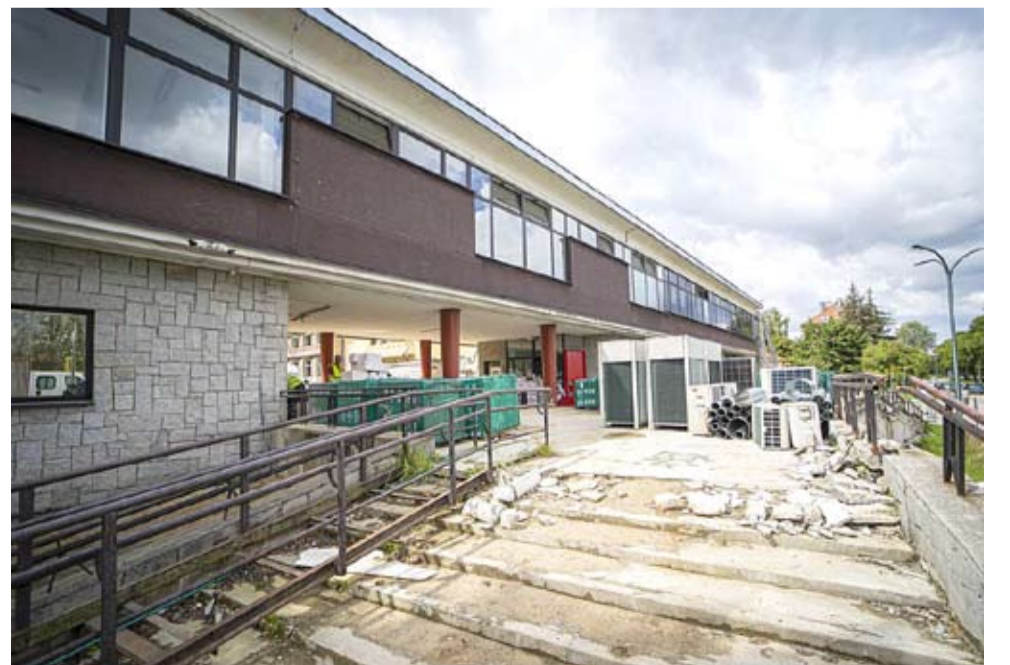
Prace remontowe w Teatrze Małym trwają zarówno wewnątrz, jak i na zewnątrz budynku.
