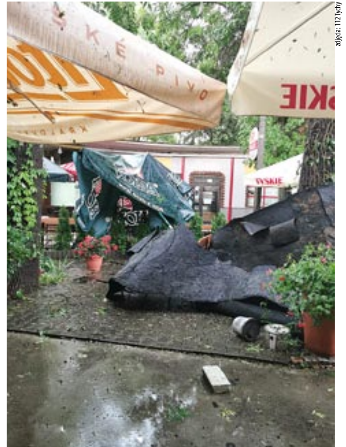
Zerwany dach baru w dawnym budynku stacji kolejowej Tychy Zachodnie.
