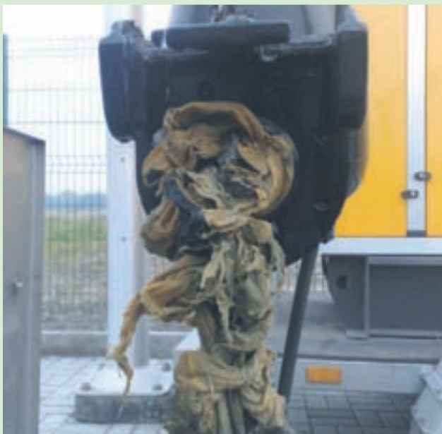
Wrzucone do kanalizacji szmaty zapchały jedną z pomp. Co miesiąc do oczyszczalni w Urbanowicach dopływa średnio 12 ton śmieci!
